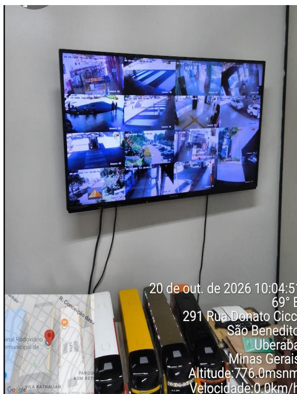
Sistema de monitoramento, funcionando
