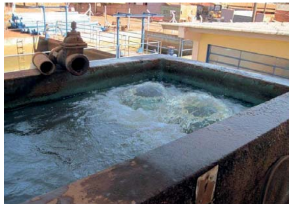
Figura 14: Tanque de entrada da água bruta na ETA.
