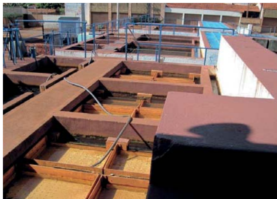
Figura 11: Vista geral dos decantadores dos módulos 01, 02 e 03 da ETA.
