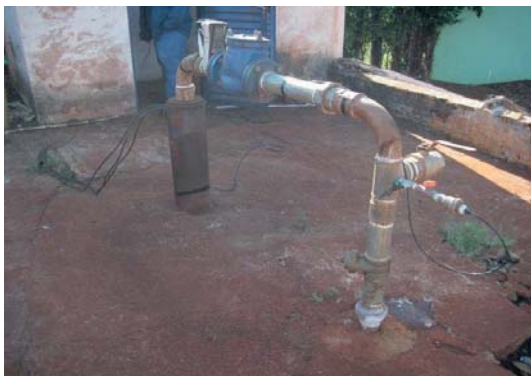
Figura 28: Captação subterrânea – Poço P4 – Nova Viradouro.
