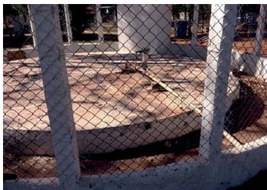
Figura 22: Captação subterrânea – Poço P1.
