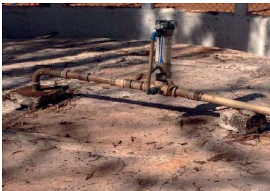
Figura 23: Captação subterrânea – Poço P1.
