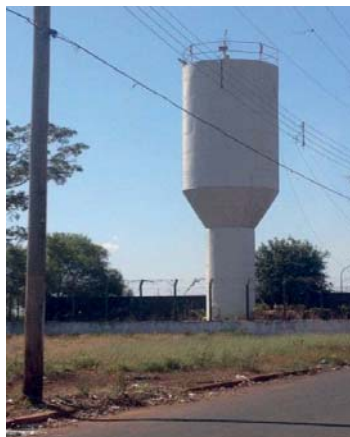
Figura 46: Reservatório R11 – Jd. Bricia.
