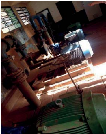
Figura 9: Casa de bombas – Unidade de captação superficial Córrego do Sucuri.
