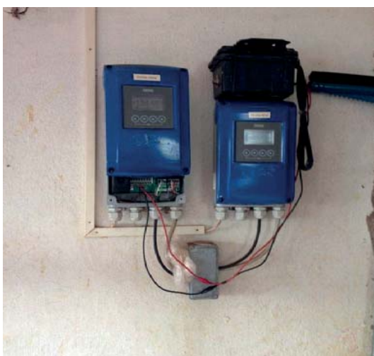
Figura 56: Medição Conversores e Transmissores.
