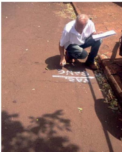
Figura 105: Pesquisa de vazamentos não visíveis – Identificação de vazamento localizado.
