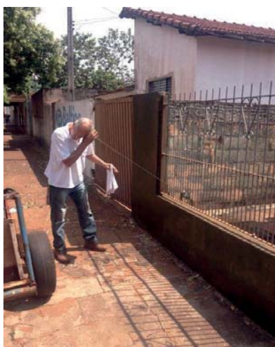
Figura 104: Pesquisa de vazamentos não visíveis – Identificação de possível vazamento através de Haste de Escuta.
