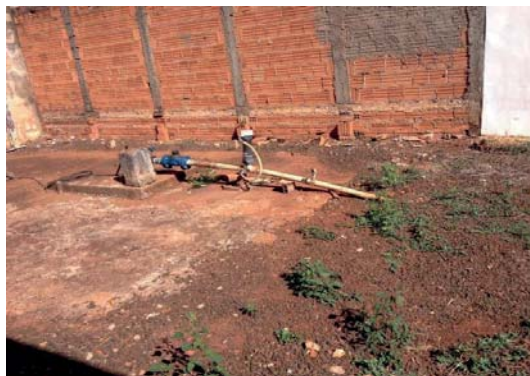
Figura 26: Captação subterrânea – Poço P2.
