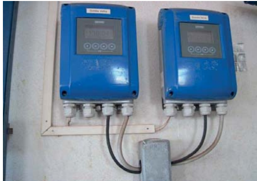
Figura 17: Hidrômetros digitais – Medição de vazão das adutoras.
