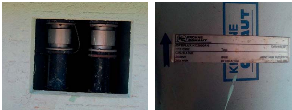
Figura 55: Medidores de Vazão.
