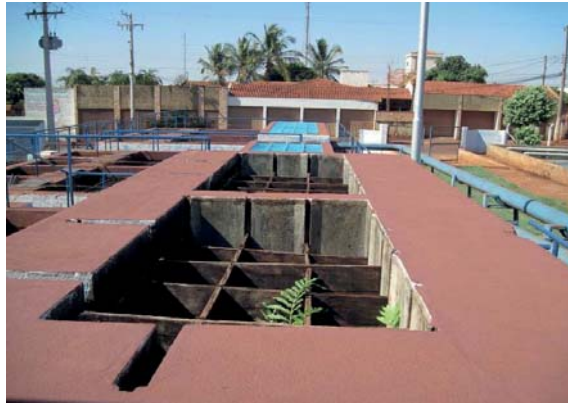
Figura 10: Vista geral dos floculadores dos módulos 01, 02 e 03 da ETA.
