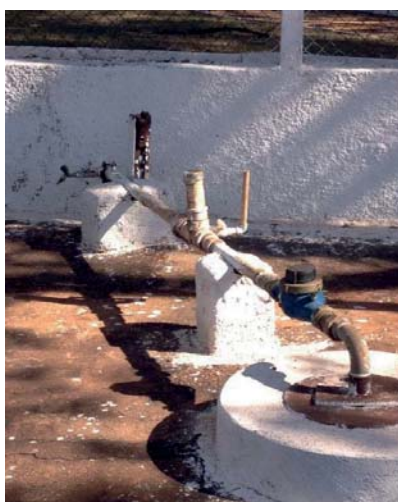
Figura 24: Captação subterrânea – Poço P3.
