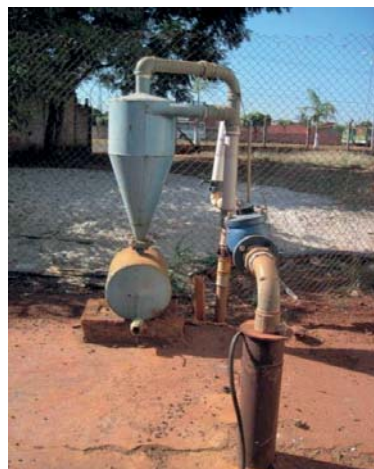
Figura 32: Captação subterrânea – Poço P6 – Almoxarifado.
