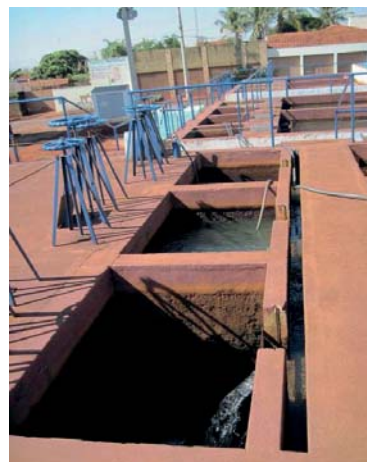
Figura 12: Vista geral dos filtros dos módulos 01, 02 e 03 da ETA.
