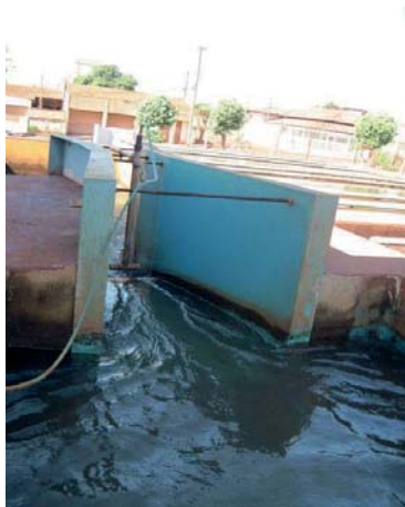
Figura 15: Medidor de vazão - Calha Parshall.
