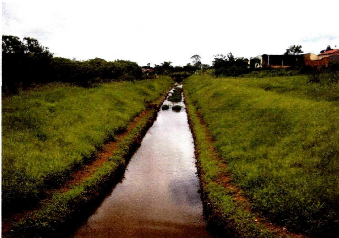
Foto. 1 – Mostra Córrego Monjolinho no perímetro urbano, canalizado por gabiões em sua porção inferior.
