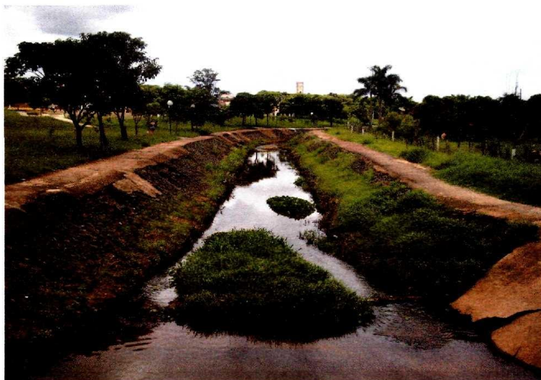
Foto. 2 - Retrata o Córrego Monjolinho canalizado por gabiões, no aguardo de manutenção
