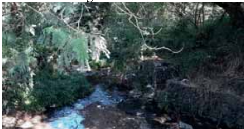
Figura 4.4.128 – Dispositivo de drenagem após a travessia na R Sete de Setembro
