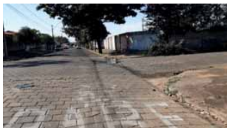
Figura 4.4.86 – R Cel Joaquim Piza, esquina com a R Mario Marangão, onde ocorrem empoçamentos
