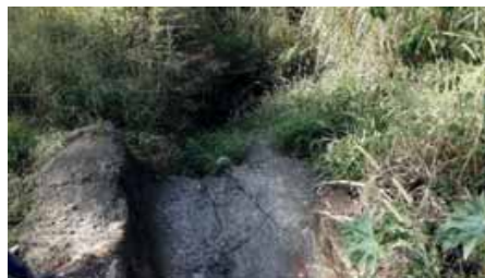
Figura 4.4.175 – Dispositivo de drenagem no Córrego Parque Real, onde há uma erosão profunda devido à falta de dissipador. A água apenas é lançada abaixo após escoar pelo concreto
