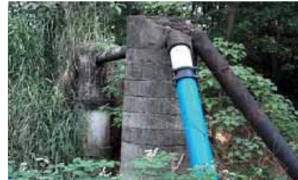
Figura 4.1.18 – Tubulação de recalque em risco devido à erosão do Ribeirão Tibiriçá
