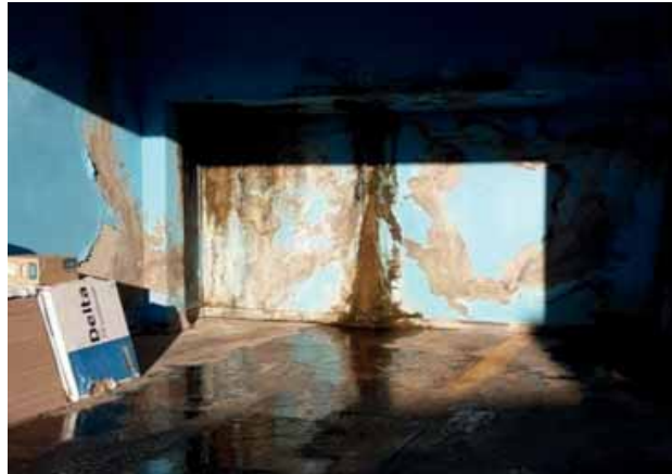
Figura 4.1.35 – Fissuras existentes na ETA Garça
