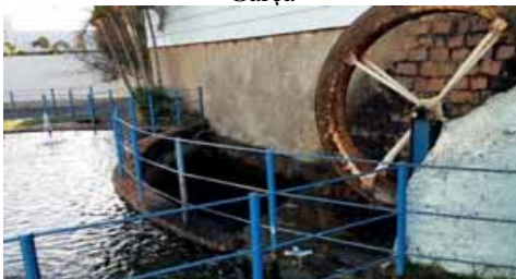
Figura 4.1.33 – Tanque em que a água da lavagem dos filtros e decantadores é armazenada até ser recirculada para a ETA Garça
