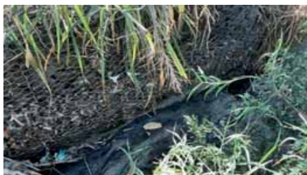
Figura 4.4.171 – Dissipador de drenagem em gabião na tubulação de drenagem superficial do Jd. Morada do Sol
