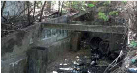
Figura 4.4.124 – Rachadura no dispositivo de drenagem da R Gabriela
