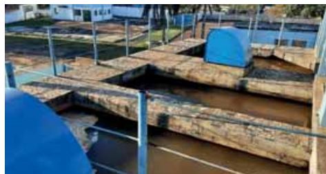
Figura 4.1.30 – Floculadores mecânicos da ETA Garça
