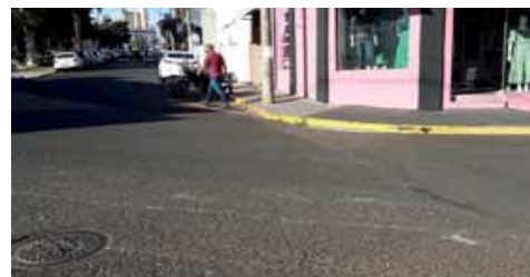
Figura 4.4.74 –R Cel Joaquim Piza, esquina com a R Heitor Penteadado, onde ocorrem empoçamentos
