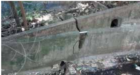
Figura 4.4.126 – Dissipador de drenagem em gabião na R Sete de Setembro, recebendo a água à montante
