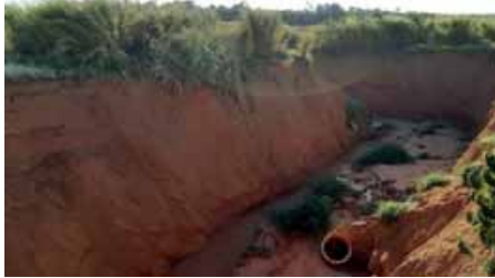
Figura 4.4.190 – Erosão na drenagem do bairro Residencial do Bosque
