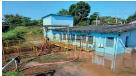
Figura 4.1.7 – Alagamento ocorrido na ECR B1 em 19 de fevereiro de 2022
