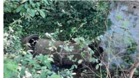
Figura 4.4.141 – Dissipador de drenagem na R Luiz Valsecchi. O corpo hídrico é canalizado da R Rosário Martino até este ponto, em que passa a escoar superficialmente
