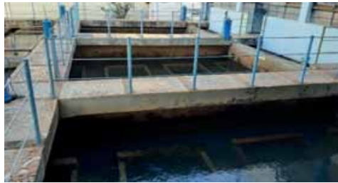
Figura 4.1.32 – Filtros da ETA Garça
