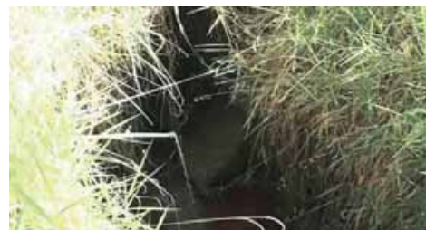
Figura 4.4.172 – Tubulação de drenagem superficial do Jd. Morada do Sol
