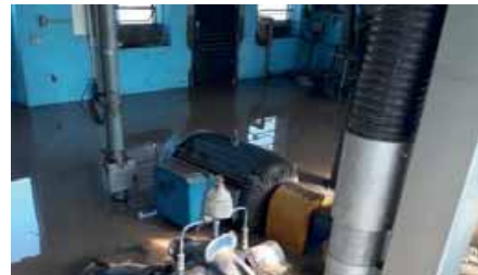
Figura 4.1.8 – Alagamento ocorrido na ECR B1 em 19 de fevereiro de 2022
