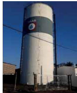
Figura 4.1.48 – Reservatório metálico Le Sorelle, de 60 m 3
