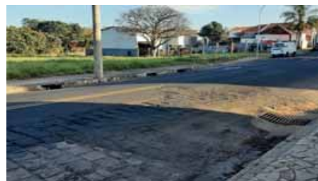
Figura 4.4.55 – Esquina da Av Presidente Vargas com a R da Estação, em que ocorrem alagamentos durante precipitações intensas
