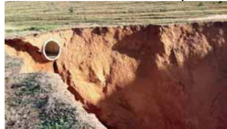
Figura 4.4.191 – Erosão na drenagem do bairro Residencial do Bosque
