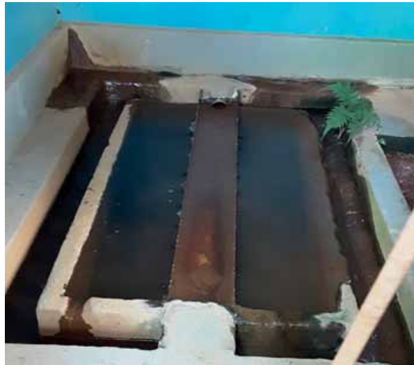
Figura 4.1.36 – Filtro da Mina de Jafa
