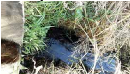
Figura 4.4.173 – Dissipador de drenagem em gabião na tubulação de drenagem superficial do Jd. Morada do Sol, adjacente à EP de esgoto Morada do Sol
