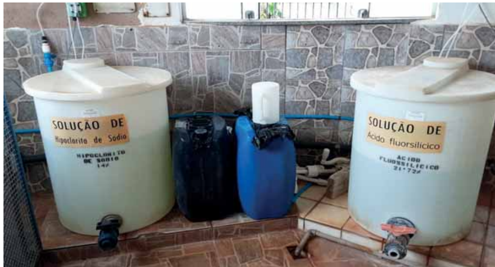
Figura 4.1.58 – Cloro e flúor utilizados nos reservatórios ETA Jafa 01 e ETA Jafa 02
