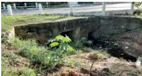
Figura 4.4.130 – Erosão em curso ao lado do dispositivo de drenagem ao fim da R Francisco da Silva Braga, comprometendo a estabilidade da alvenaria
