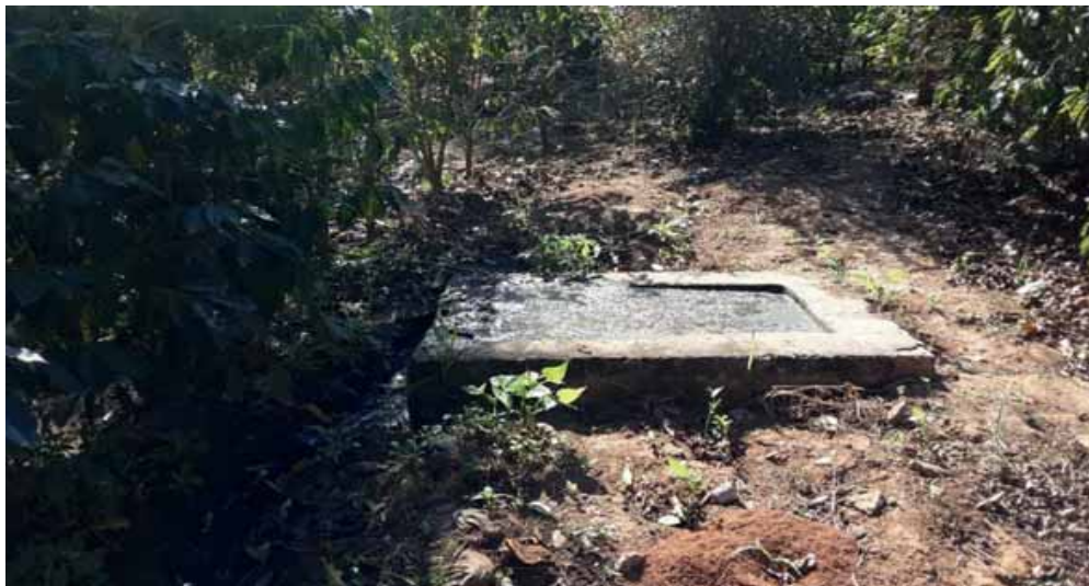
Figura 4.2.58 – Caixa de esgoto em rede próxima à esquina da Rua Tupi com a Rua São Paulo,
