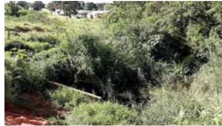
Figura 4.4.133 – Canaleta de drenagem degradada na esquina da R Tupy com a R São Paulo
