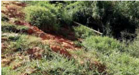
Figura 4.4.132 – Canaleta de drenagem degradada na esquina da R Tupy com a R São Paulo
