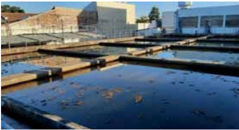
Figura 4.1.31 – Decantadores da ETA Garça
