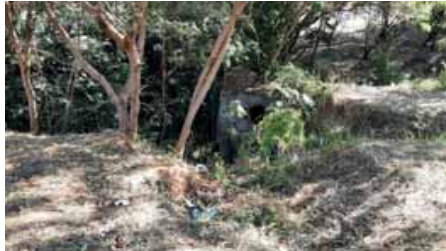
Figura 4.4.140 – Dispositivo de drenagem na esquina da R Rosário Martino com a R Luiz Valsecchi
