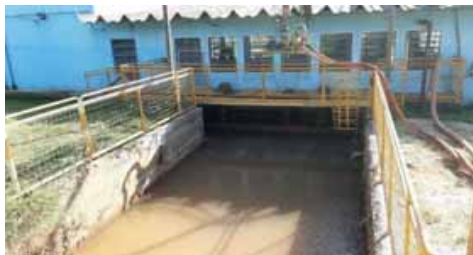
Figura 4.1.5 – Poço de sucção da ECR B1, em que se pode ver à esquerda a tubulação de entrada da água captada no Poço Guarani
