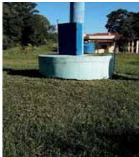
Figura 4.1.47 – Reservatório metálico Jd. Sol Nascente (Sesi), de 1.000 m 3
