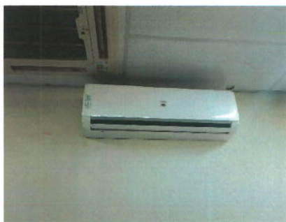
AR CONDICIONADO ELGIN 30 000 BTUS PATRIMONIO 202 213
