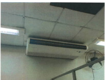
AR CONDICIONADO ELGIN 48 000 BTUS PATRIMONIO 202 206
