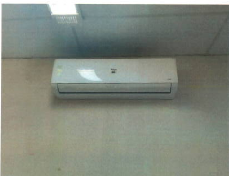
AR CONDICIONADO ELGIN 30 000 BTUS PATRIMONIO 202 216
