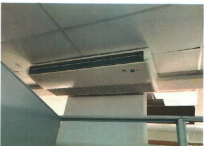
AR CONDICIONADO ELGIN 48 000 BTUS PATRIMONIO 202 208
