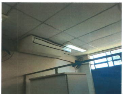
AR CONDICIONADO ELGIN 48 000 BTUS PATRIMONIO 202 207
