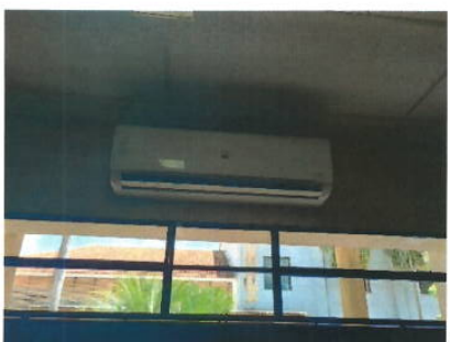
AR CONDICIONADO ELGIN 30 000 BTUS PATRIMONIO 202 214
