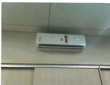
AR CONDICIONADO ELGIN 18 000 BTUS PATRIMONIO 202 218
