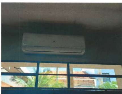
AR CONDICIONADO ELGIN 30 000 BTUS PATRIMONIO 202 215
