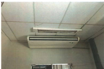
AR CONDICIONADO ELGIN 48 000 BTUS PATRIMONIO 202 205
