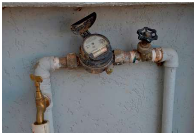
Figura 43 - Ligação domiciliar - padrão abrigado - medidor inclinado
