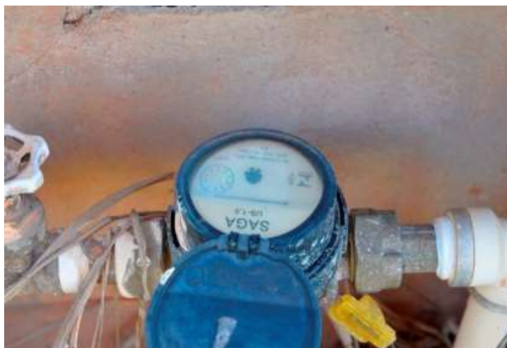
Figura 38 - Ligação domiciliar - hidrômetro instalado com inadequações e cúpula semi embaçada
