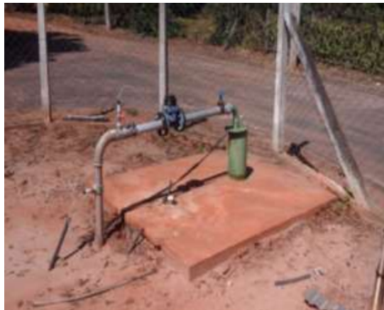
Figura 19 – Aspectos do cavalete do poço P8 .
