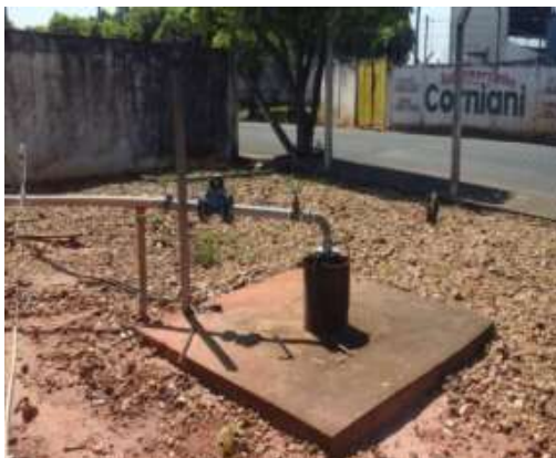
Figura 11 – Vista do cavalete do poço P4.
