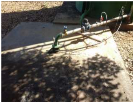
Figura 13 – Aspectos do cavalete do poço P5 .
