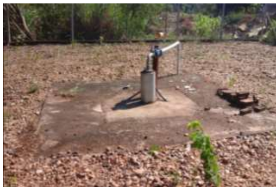
Figura 25 – Aspectos do cavalete do poço P 11 .
