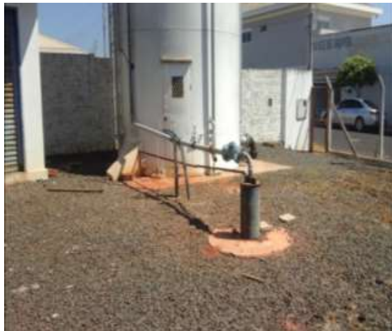
Figura 23 – Aspectos do cavalete do poço P 10 .
