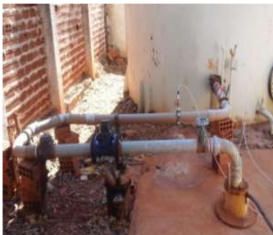
Figura 17 – Aspectos do cavalete do poço P 7.
