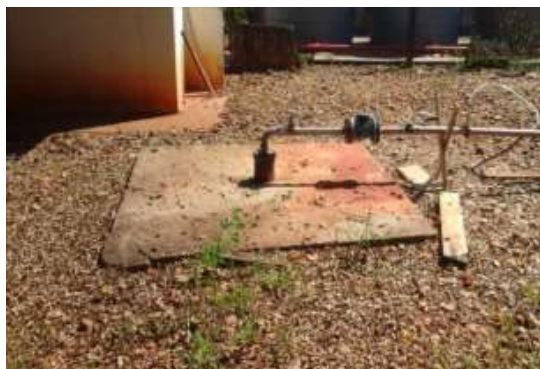
Figura 21 – Aspectos do cavalete do poço P9 .
