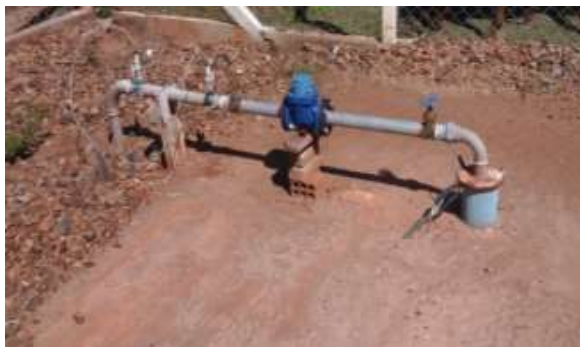
Figura 27 – Aspectos do cavalete do poço P 12 .
