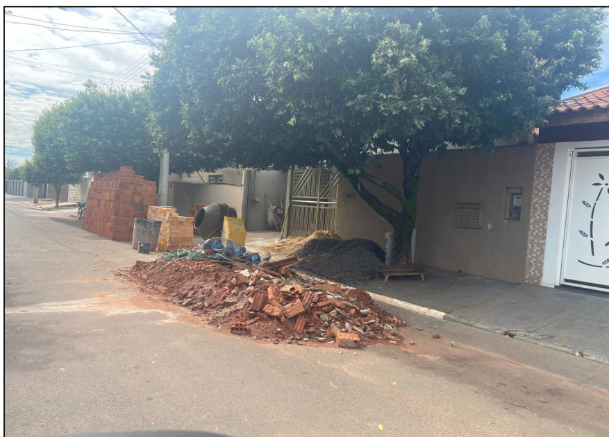
Figura 28 – Materiais e Resíduos da Construção Civil em via pública.
