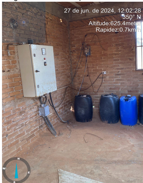
Figura 109: Casa de químicos e bomba.
