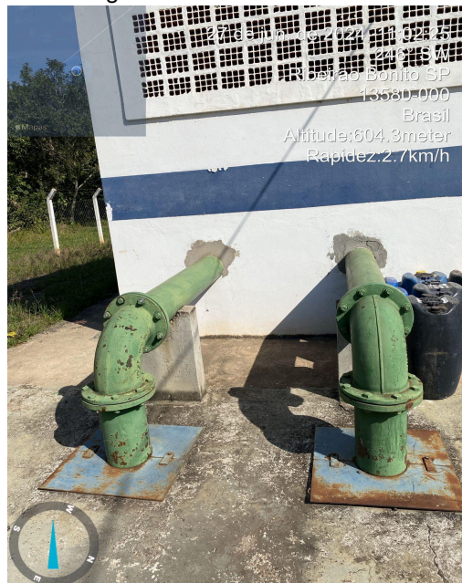
Figura 87: Casa de bombas.
