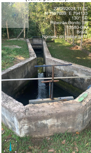
Figura 78: Sistema de tratamento d'água (calha parshall).
