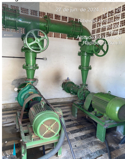
Figura 91: Bombas de abastecimento.
