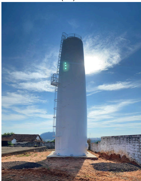
Figura 63: Reservatório elevado metálico (R2).
