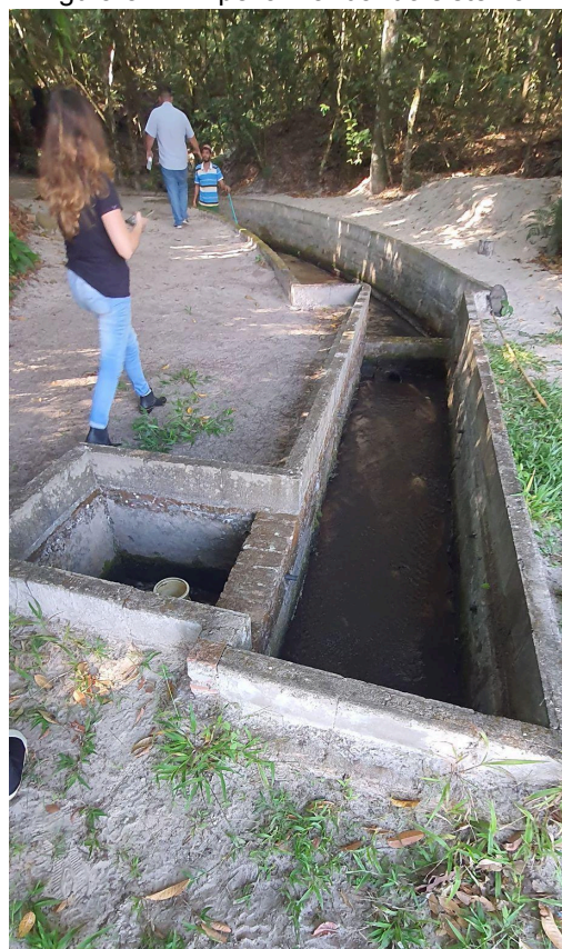
Figura 51: Limpeza manual do sistema.
