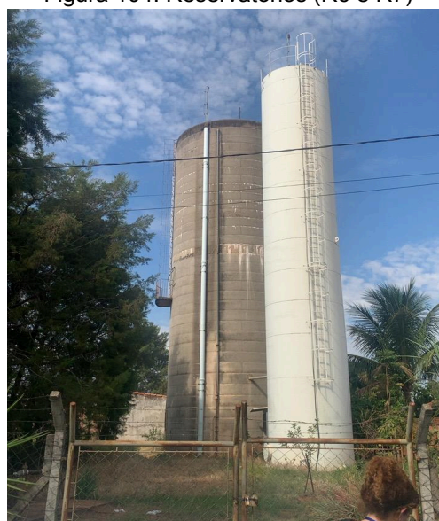
Figura 104: Reservatórios (R6 e R7)
