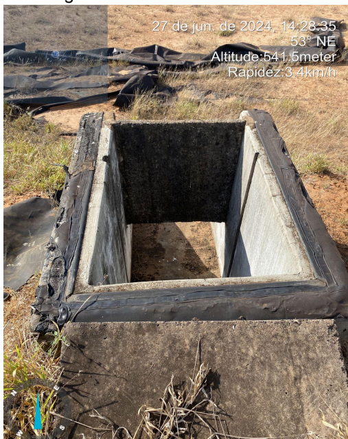
Figura 141: Estrutura da ETE 2.
