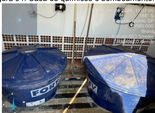
Figura 94: Casa de químicos e bombeamento.
