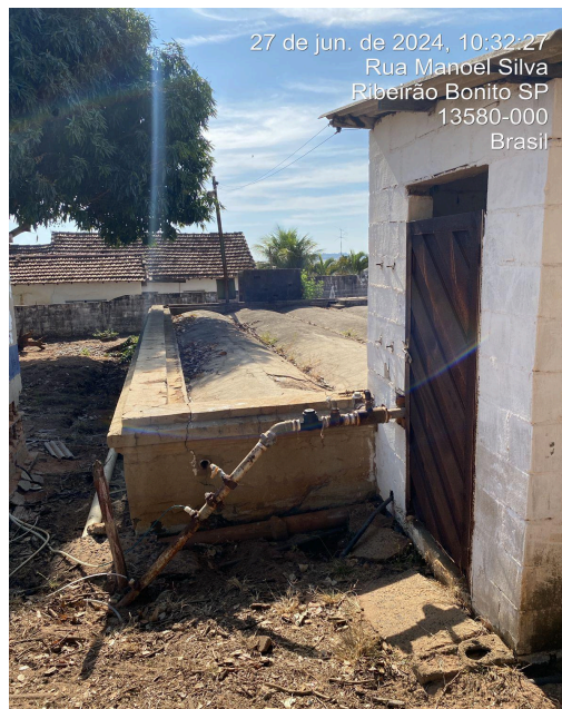
Figura 64: Casa de bombeamento.
