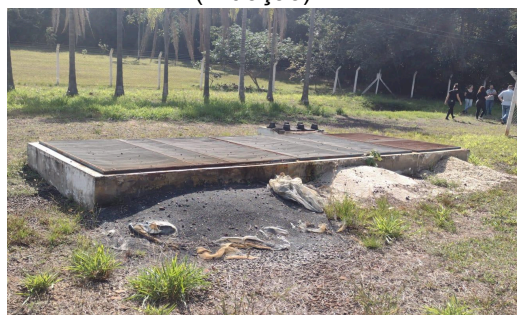
Figura 82: Sistema de tratamento d'água (Filtração).
