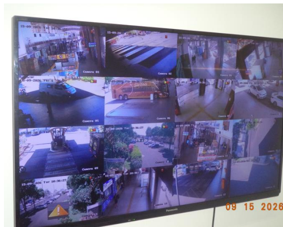
Sistema de câmara funcionando
