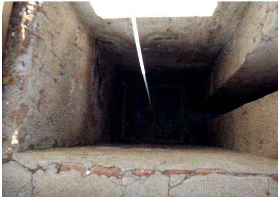
Foto 3.63 – Detalhe de caixa que encaminha esgoto para ETE 2
