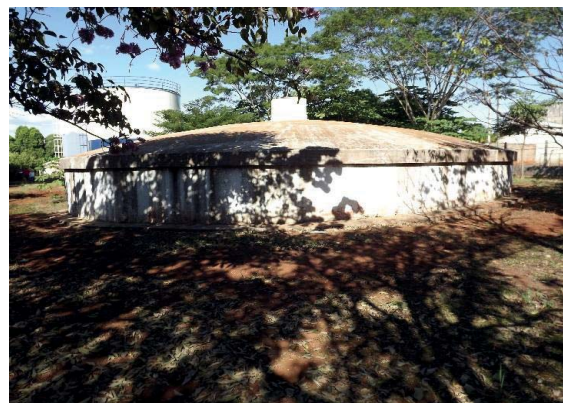
Foto 3.37 – RSE Reserva II – estado regular de conservação.
