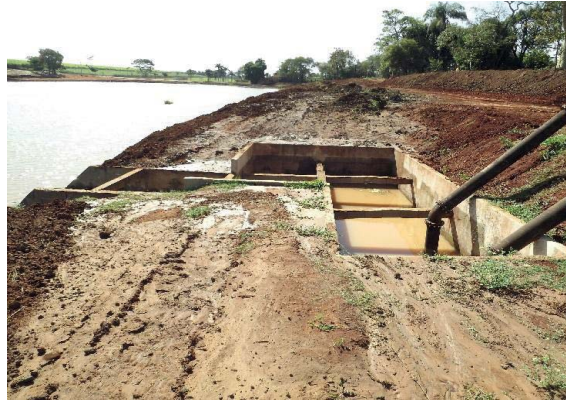
Foto 3.9 – Vista geral do poço de sucção do ponto de captação superficial no Córrego Viradouro
