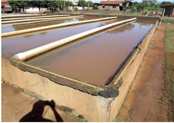
Foto 3.24 – Vista do sistema de tratamento de lodo da ETA
