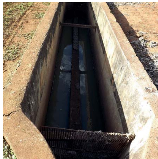
Foto 3.62 – Caixa de areia
