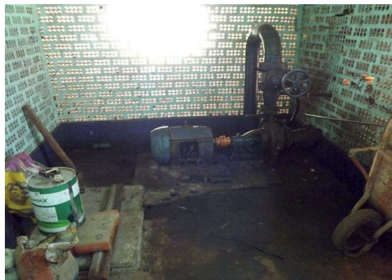
Foto 3.44 – Conjunto motobomba 2 da EEAT I ETA
