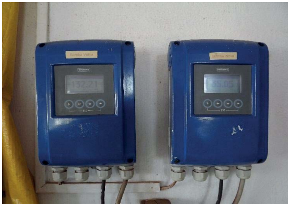
Foto 3.26 – Detalhe de medidores de vazão na entrada da ETA
