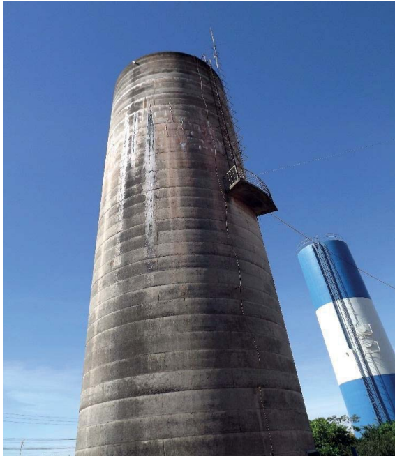
Foto 3.30 – Vista do REL Vila Nova, com detalhe para vazamento na lateral
