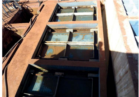
Foto 3.19 – Detalhe conjunto de decantadores do tipo “bandeja”
