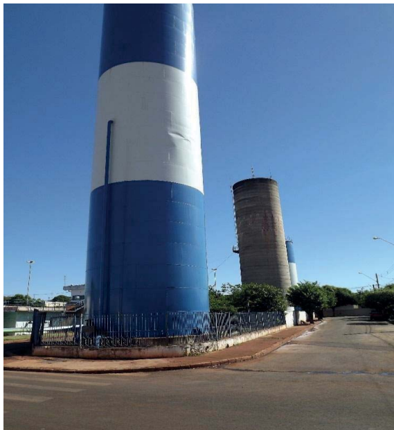
Foto 3.28 – Vista geral do RAP COHAB (câmara inferior) e REL Vila Nova (câmara superior)
