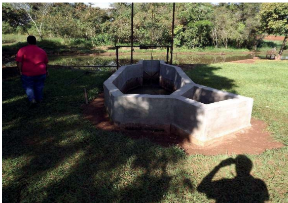
Foto 3.3 – Caixa de passagem para captação de água superficial
