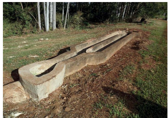
Foto 3.55 – Caixa de areia
