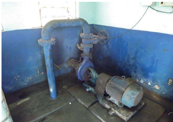
Foto 3.43 – Conjunto motobomba 1 da EEAT I ETA
