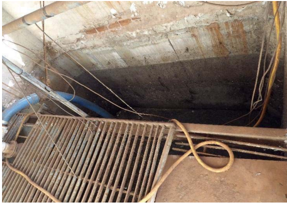
Foto 3.50 – Poço de Sucção EEE ETE 2
