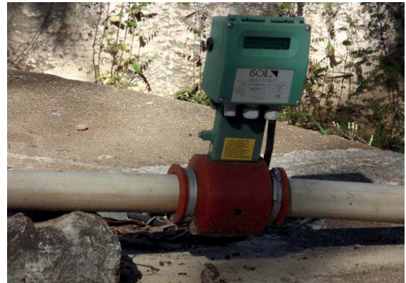
Foto 3.11 – Detalhe de macromedidor instalado no Poço P1
