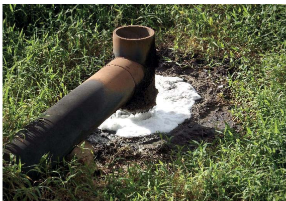
Foto 3.58 – Detalhe da entrada da lagoa facultativa
