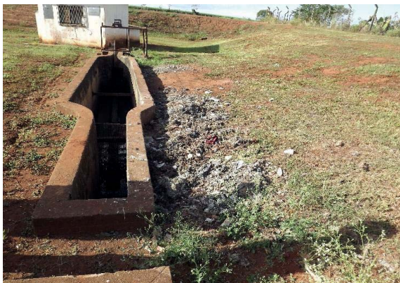
Foto 3.61 – Vista geral do tratamento preliminar com resíduos sólidos acumulados ao lado
