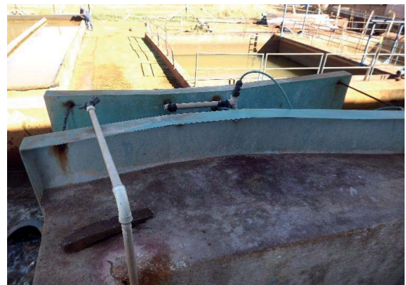
Foto 3.17 – Ponto de aplicação de policloreto de alumínio (coagulante) na entrada da ETA
