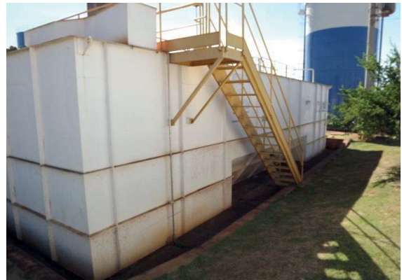
Foto 3.21 – Vista geral do módulo 4 – ETA Compacta
