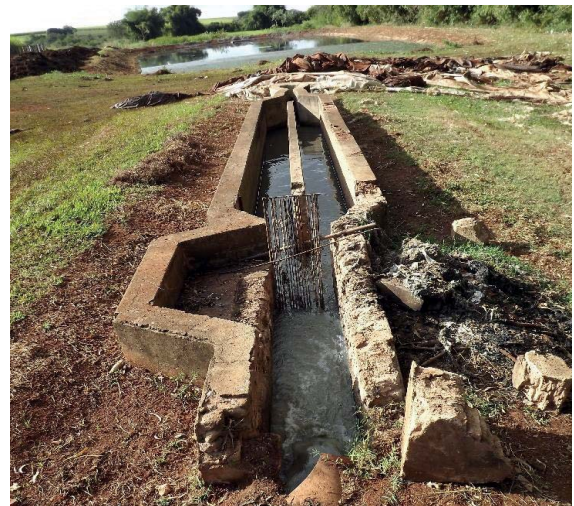
Foto 3.53 - Vista geral – Tratamento Preliminar em estado precário de conservação
