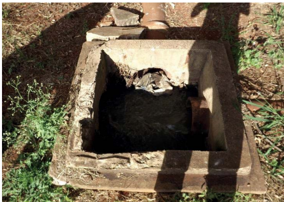
Foto 3.52 – By-pass na caixa de distribuição – Entrada ETE
