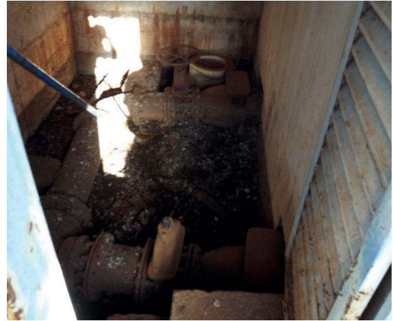
Foto 3.51 – Saída da EEE ETE 2 em condições precárias
