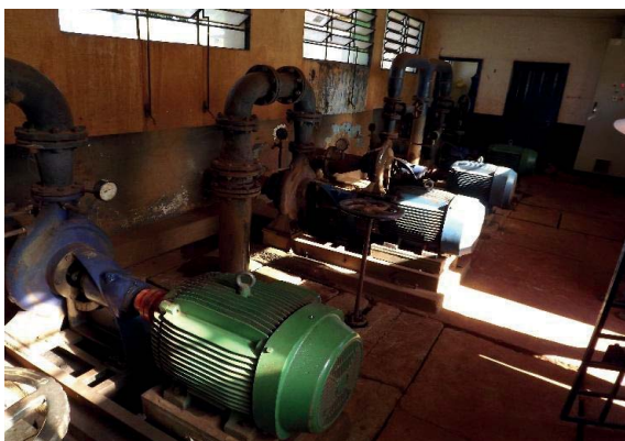
Foto 3.5 – Vista interna – Casa de bombas de recalque
