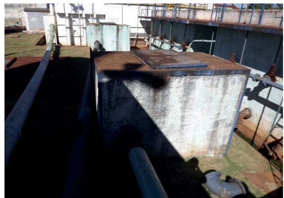
Foto 3.23 – Detalhe da caixa de passagem para retrolavagem dos filtros
