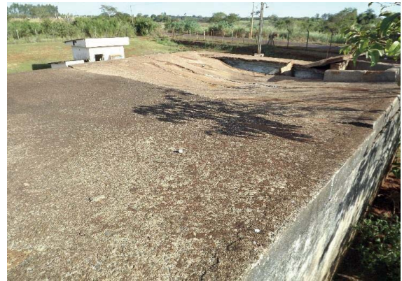
Foto 3.64 – Caixa de acumulação com problemas na laje
