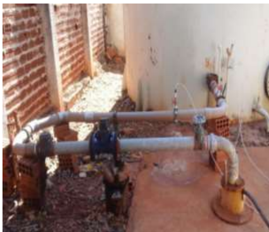
Figura 17 – Aspectos do cavalete do poço P 7.
