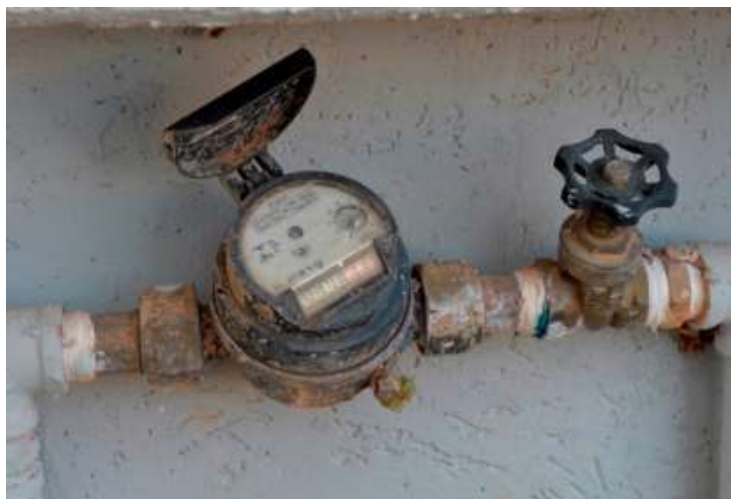
Figura 35 - Ligação domiciliar – medidor com cúpula semi embaçada
