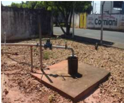
Figura 11 – Vista do cavalete do poço P4.
