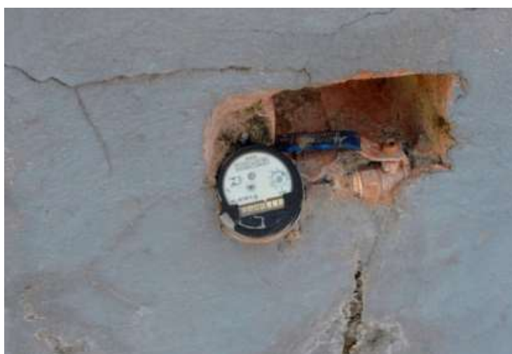
Figura 42 - Ligação domiciliar - instalação de cavalete totalmente inadequada
