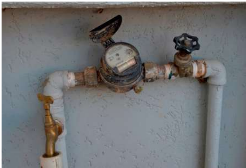
Figura 43 - Ligação domiciliar - padrão abrigado - medidor inclinado
