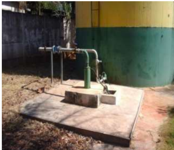
Figura 15 – Aspectos do cavalete do poço P6.
