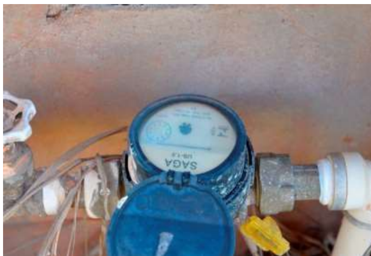
Figura 38 - Ligação domiciliar - hidrômetro instalado com inadequações e cúpula semi embaçada
