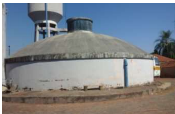
Figura 9 – Vista do reservatório apoiado RA-3.
