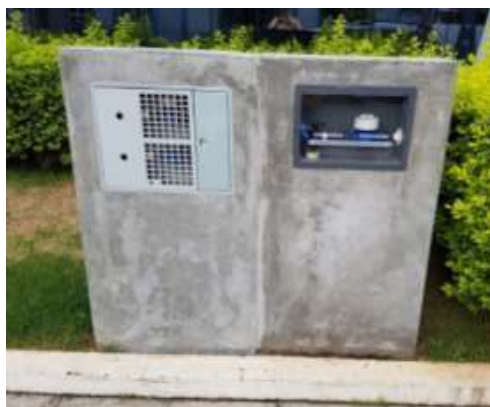
Figura 46 - Caixa de Abrigo para Hidrômetro instalada em MURETA
