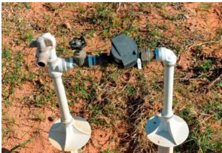
Figura 31 - Ligação domiciliar externa tipo cavalete
