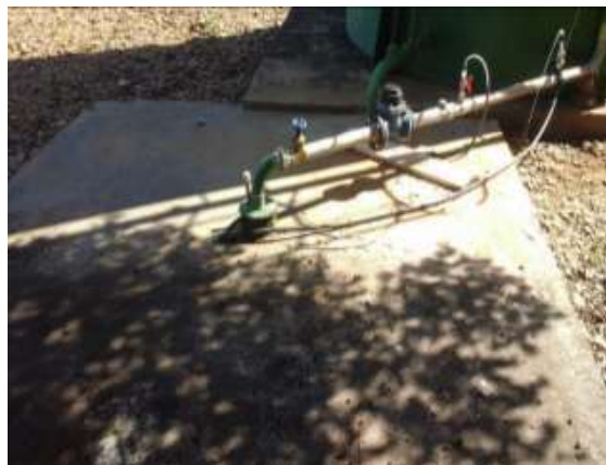
Figura 13 – Aspectos do cavalete do poço P5 .
