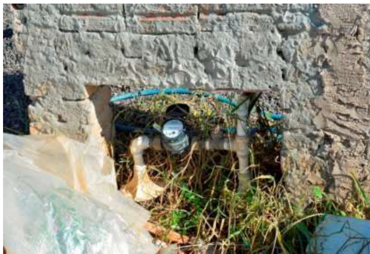
Figura 39 - Ligação domiciliar padrão - cavalete instalado em local inadequado e sem manutenção
