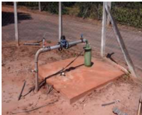
Figura 19 – Aspectos do cavalete do poço P8.
