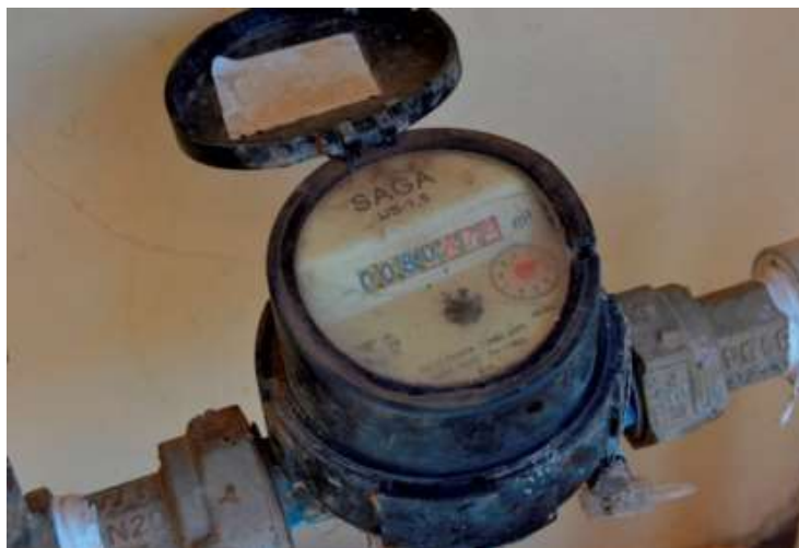
Figura 41 - Ligação domiciliar - medidor em estado de conservação inadequado
