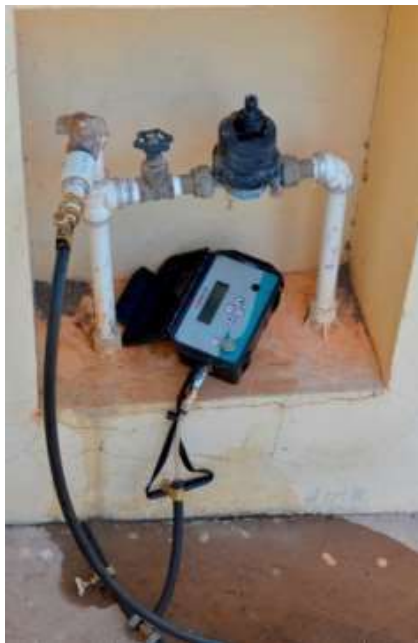
Figura 33 - Ligação domiciliar externa tipo cavalete embutida em muro
