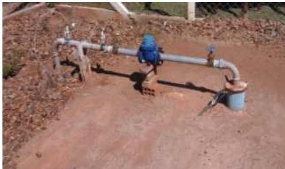
Figura 27 – Aspectos do cavalete do poço P 12.
