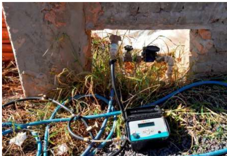
Figura 37 - Ligação domiciliar - cavalete montado em local totalmente inadequado
