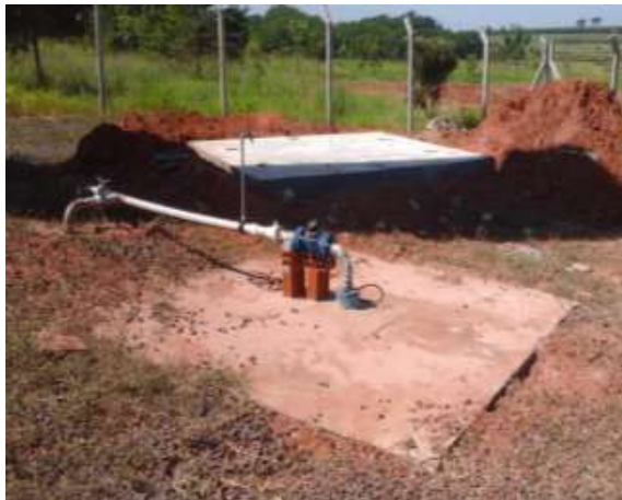
Figura 28 – Aspectos do cavalete do poço P 13.
