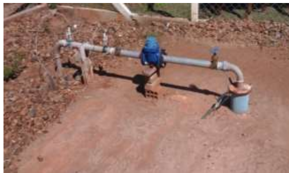
Figura 27 – Aspectos do cavalete do poço P 12.
