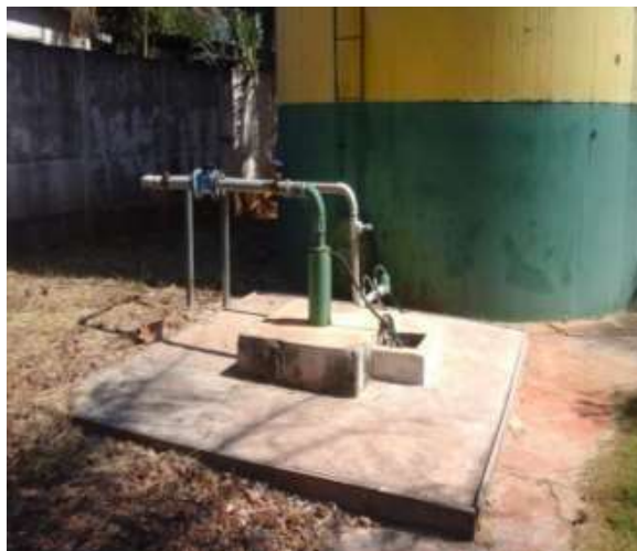
Figura 15 – Aspectos do cavalete do poço P6.
