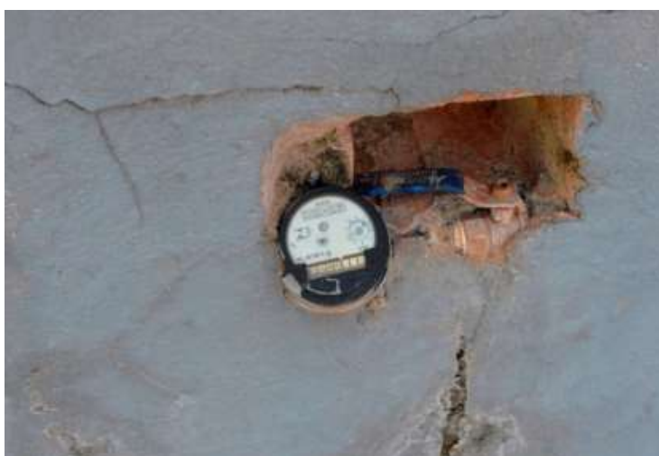
Figura 42 - Ligação domiciliar - instalação de cavalete totalmente inadequada
