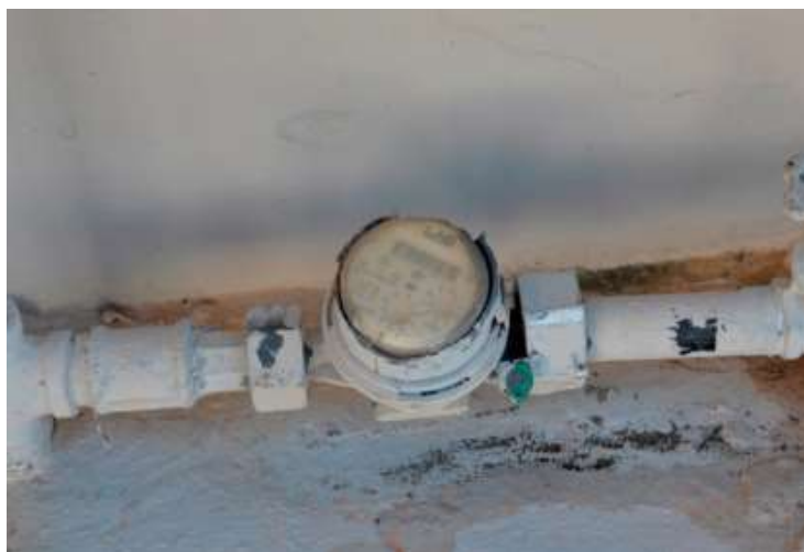
Figura 40 - Ligação domiciliar – Detalhe de Medidor
