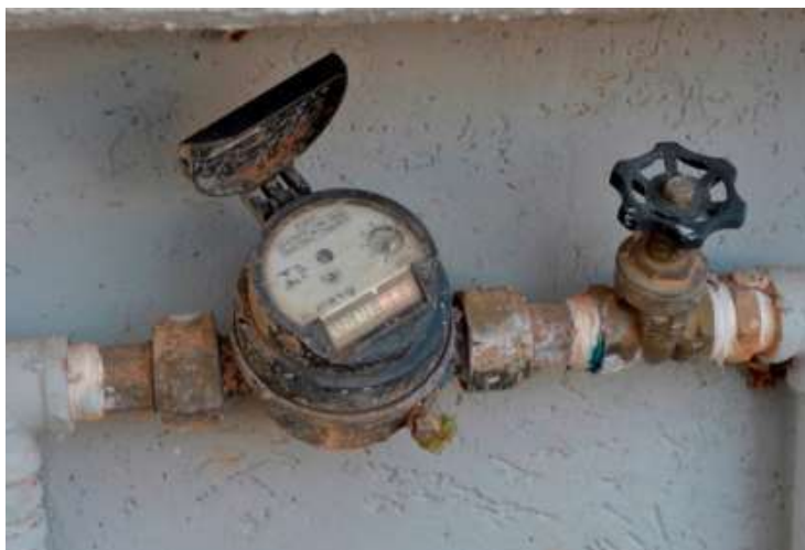
Figura 35 - Ligação domiciliar – medidor com cúpula semi embaçada
